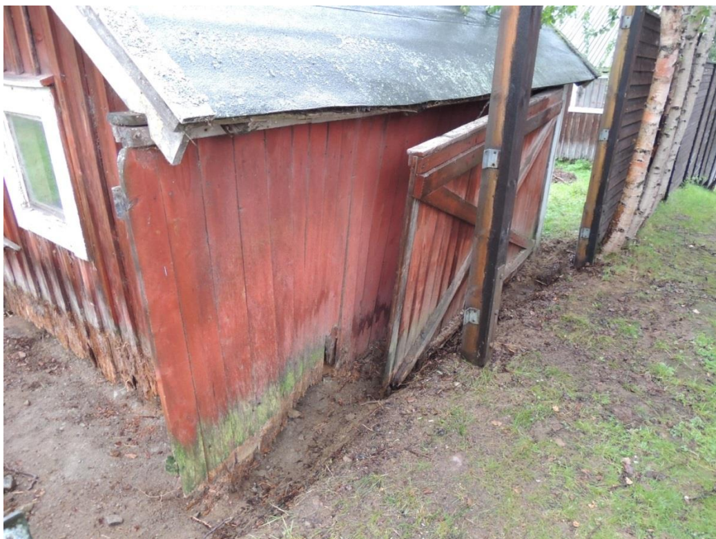
Bild 51 Lilla uthuset, Doktorsgården, rötskadad vägpanel med upphängd grind från det gamla planket mot sjukstugan (finns på målning från 1947, SMA) Foto av L. Liedgren, 2013.
