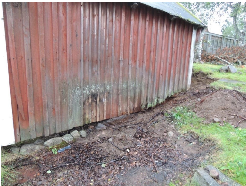
Bild 50 Lilla uthuset, Doktorsgården, rötskadad vägpanel i långvägg. Foto av L. Liedgren, 2013.
