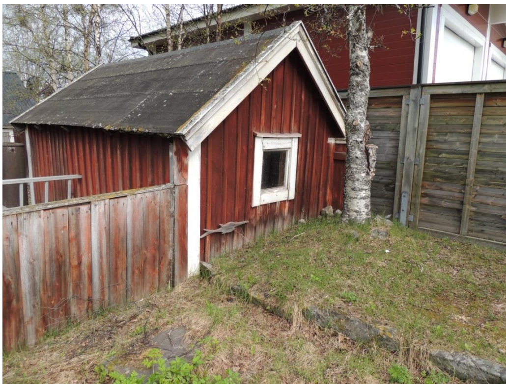
Bild 48 Lilla uthuset, Doktorsgården, med jordtäkt gavelvägg, före upprustning. Foto av L. Liedgren, 2012.
