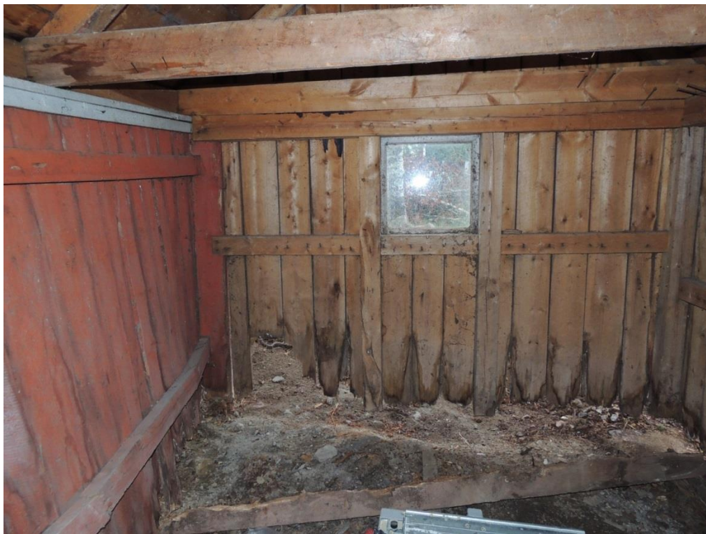
Bild 49 Lilla uthuset, Doktorsgården, rötskadat väggvirke i gavel, från insidan. Foto av L. Liedgren, 2013.
