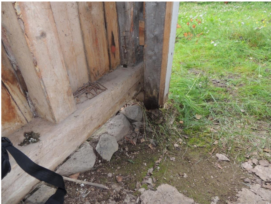
Bild 45 Lilla uthuset, Doktorsgården, rutten underdel av väggstolpe vid dörr §. Foto av L. Liedgren, 2013.
