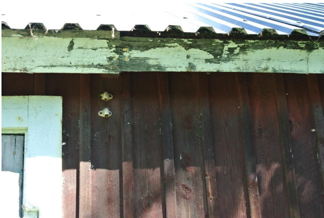
Bild 56 Stora uthuset, Doktorsgården, rötskadade delar av takfotsbräda. Foto av K. Markström, A-trä, 2013.
