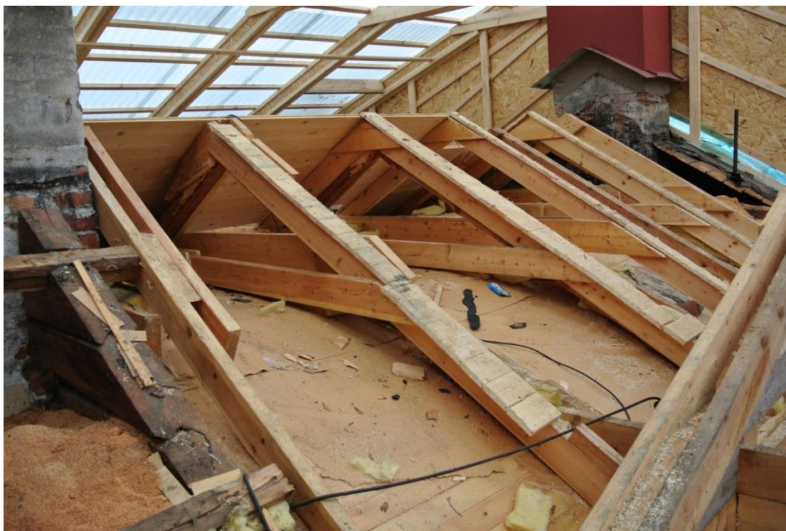
Bild 13 Doktorsgården, bostadshus, gamla takkonstruktionen över bibliotek med förstärkningar gjorda 1994. Under takstolar är gullfiber som tillförts 1994. Foto av K. Markström, A-trä, 2013.
