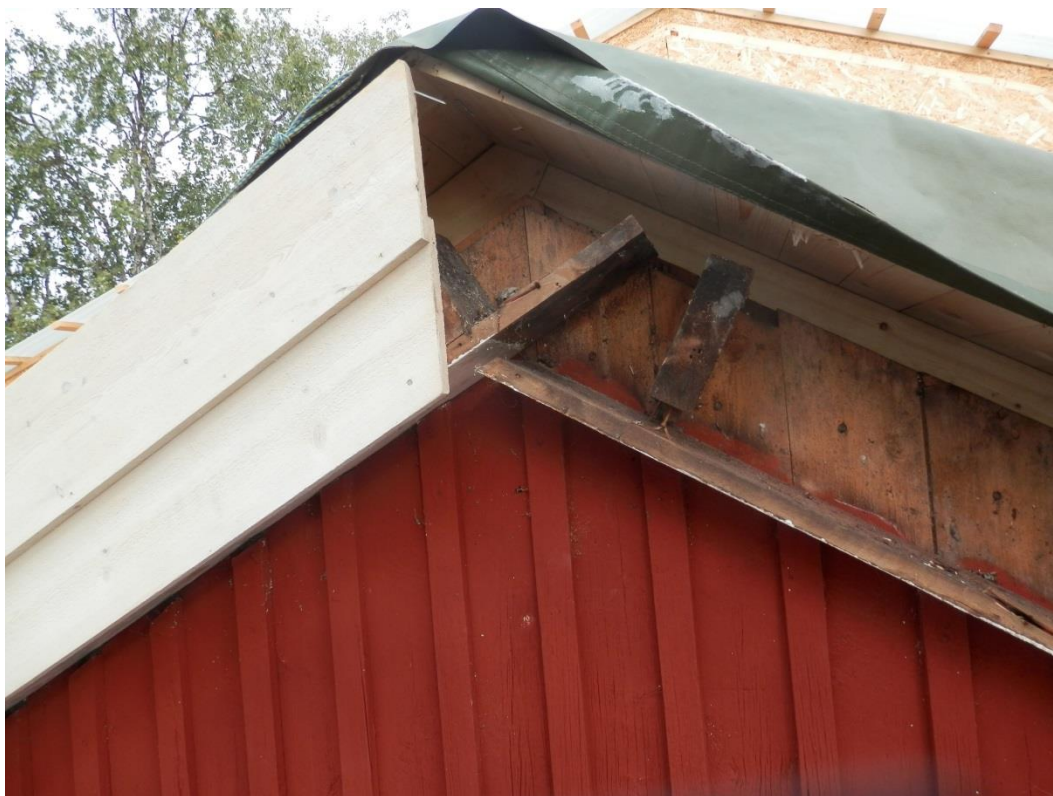
Bild 27 Doktorsgården, bostadshus. Här syns påbyggnaden av husets tak i en av gavlarna. Foto av S.-E. Elveback, A-trä, 2013.
