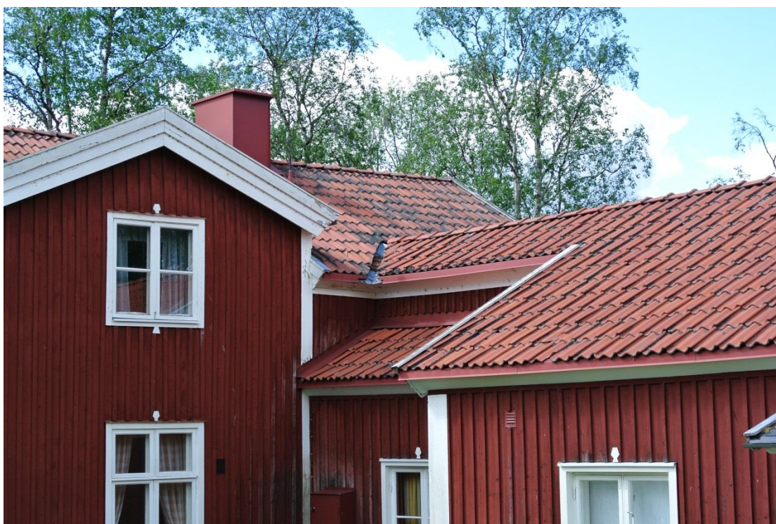
Bild 20 Doktorsgården, möte med flygelbyggnad. Trånga rännalar har gjort att löv och fukt ansamlats. Foto av K. Markström, A-trä, 2013.
