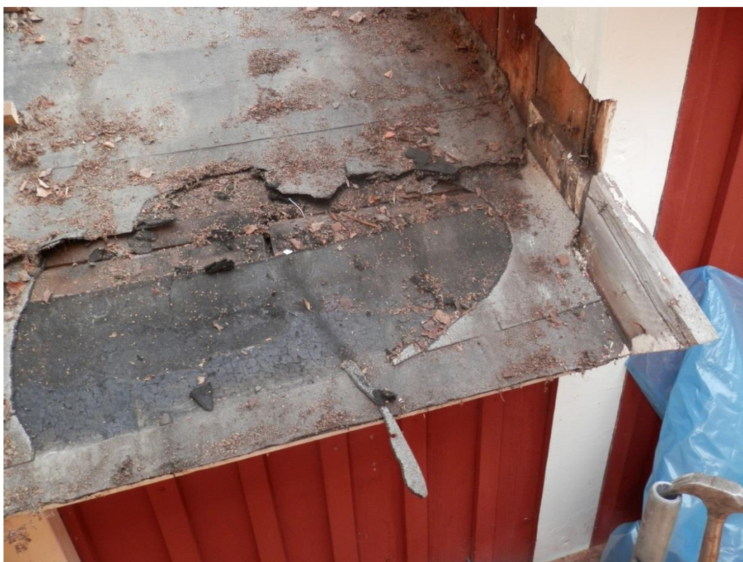
Bild 15 Doktorsgården, bostadshus, dubbla lager av takpapp under tegeltak. Foto av S.-E. Elveback, A-trä, 2013.
