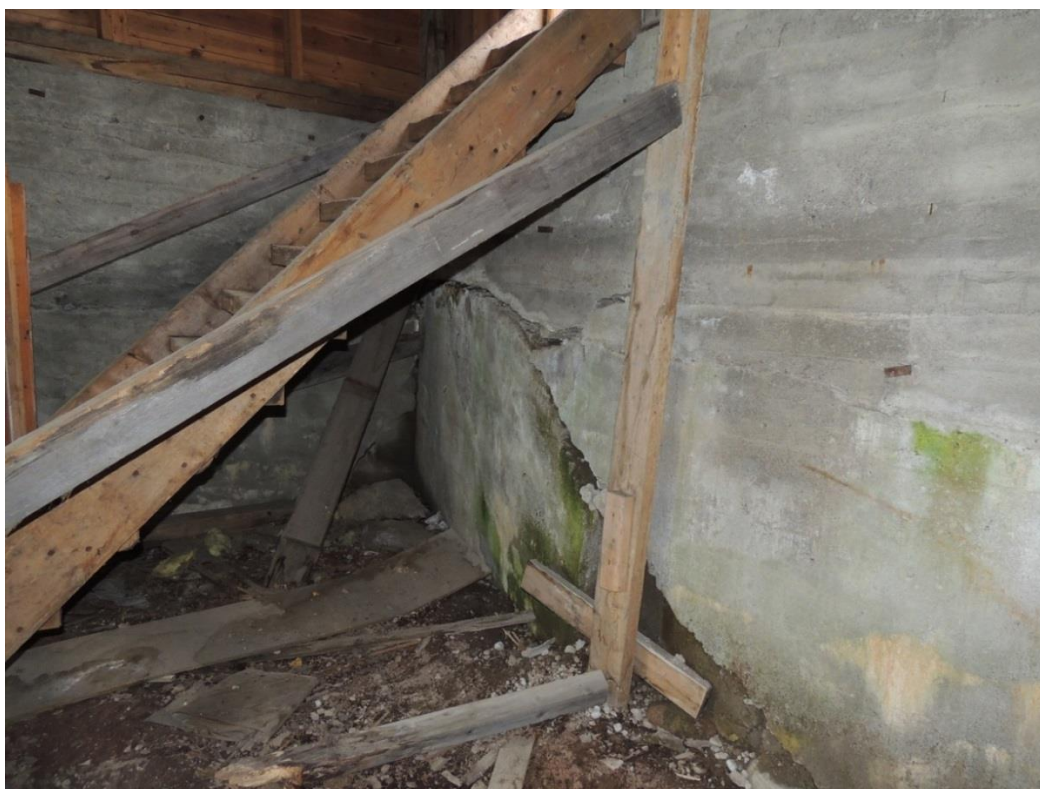
Bild 58 Stora uthuset, Doktorsgården, sprucken betongvägg, insida. Foto av L. Liedgren, 2013.
