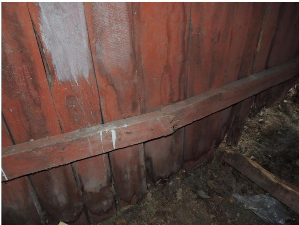
Bild 47 Lilla uthuset, Doktorsgården, avbruten väggregel och rötskadat väggvirke, från insidan, ursprungligen plank som omformats till väggdel. Foto av L. Liedgren, 2013.
