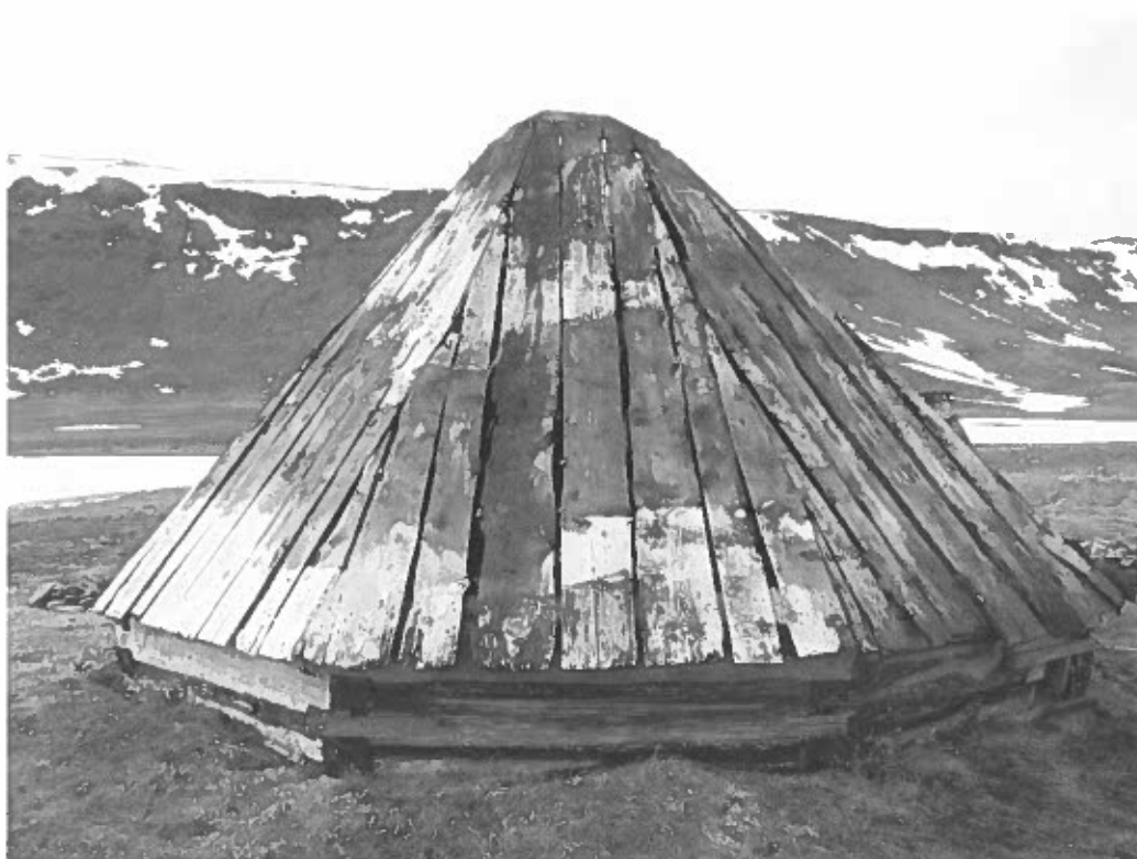
Bild 8 Vuorekkåtan, takbrädor, före upprustning. Foto av M. Johansson, 2005.
