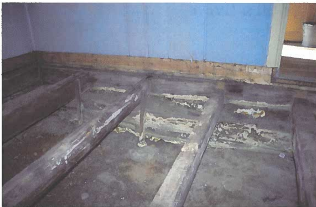
Bild 9 Suobdek, mangårdsbyggnad, kök, svampbildning eller sk "tjuka" på syllvarv. Foto av L. Liedgren, 2003.
