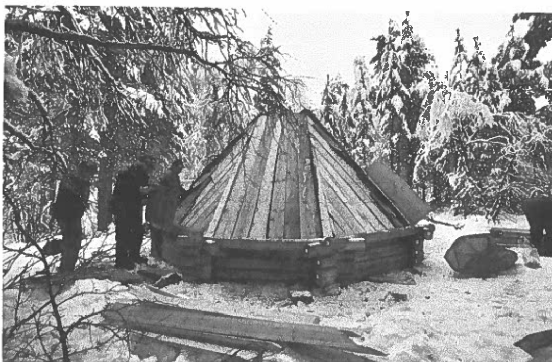
Bild 18 Uppsättning av åttkantig timrad kåta vid gamla nomadskolan, takläggning. Foto av L. Liedgren, 2002.
