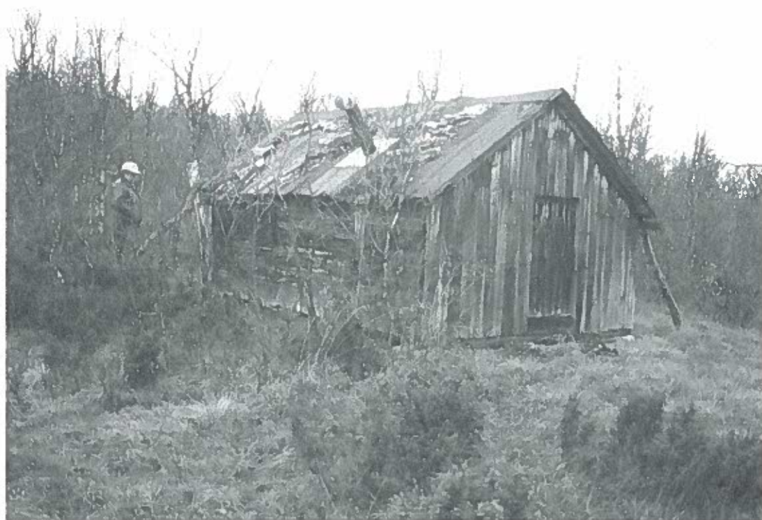
Bild 3 Timrad stuga vid Arvassjön, före upprustning. Foto fr Ö av L. Liedgren, 2001.
