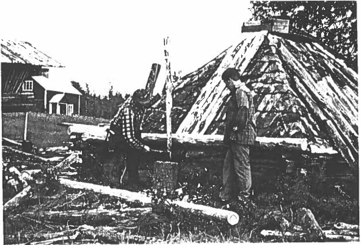
Bild 7. Nils-Gunnar Flinkfeldt, Radnejaur, med son. Renovering av yttertak till kåtan (nr 1). Foto av L. Liedgren, fr väster, 1994.
